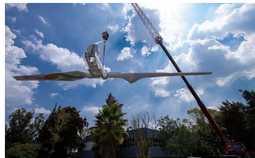
Figura 5.- Aerogenerador-UAQ Fuente: Diario Querétaro (2017)
