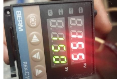
Figura 13.- Comprobación de funcionamiento del termostato. (Autoría propia)
